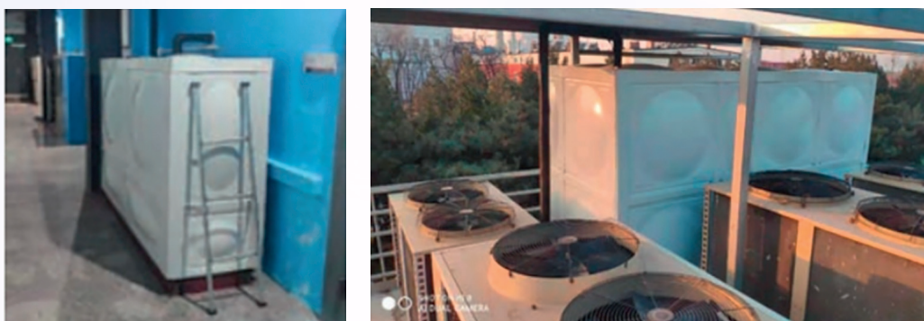
圖：北方所對設備冷卻水和水系統產生廢水進行回收再利用
